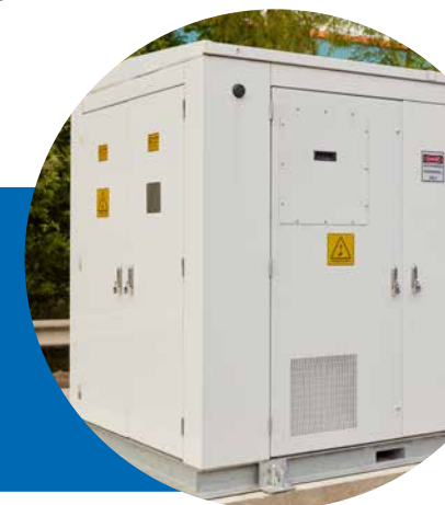
ATS teste un système capable de stocker jusqu'à 360 kWh d'énergie dans des batteries lithium-ion depuis mi-2019.
