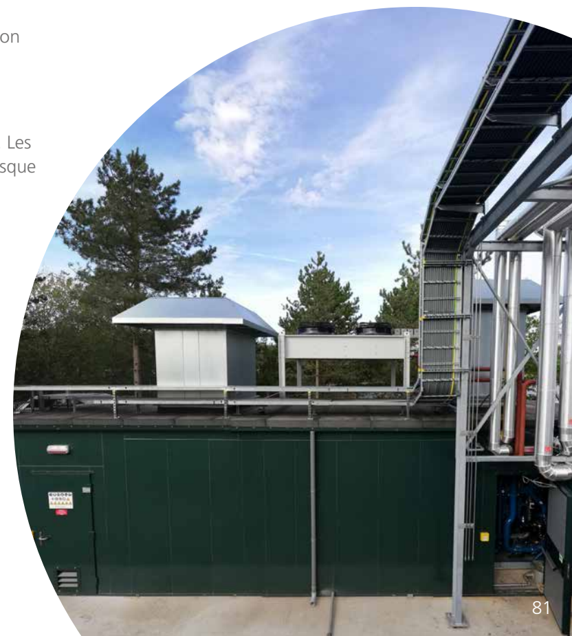
La nouvelle unité de cogénération.
